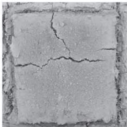
Les enduits qui présentent des fentes sont trop riches en argile
